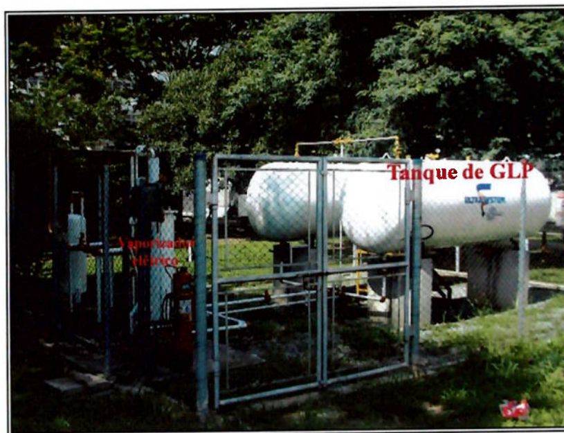
Figura 3.10: Foto ilustrativa do tanque de GLP e a esquerda o vaporizador elétrico.
