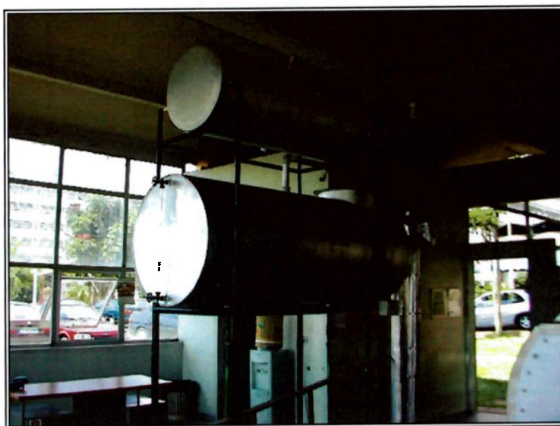
Figura 3.8: Foto misturador. Acima está o reservatório de água fria e abaixo o misturador.
