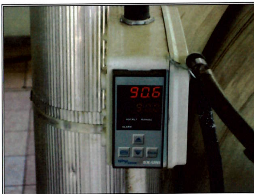
Figura 3.7: Indicação de temperatura do reservatório térmico, em horário sem consumo de água quente.
