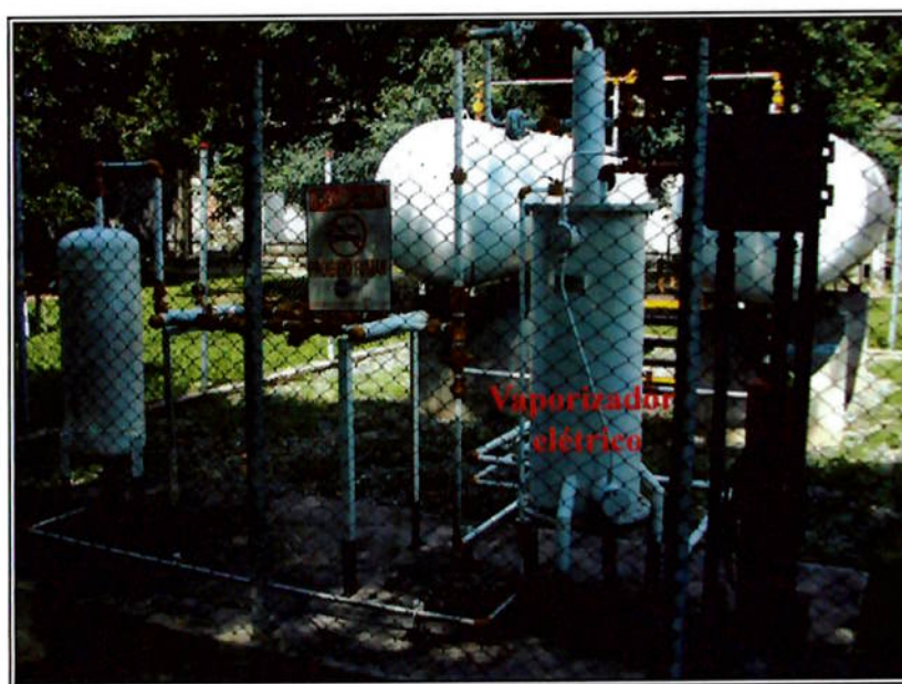
Figura 3.9: Foto vaporizador elétrico de GLP.
